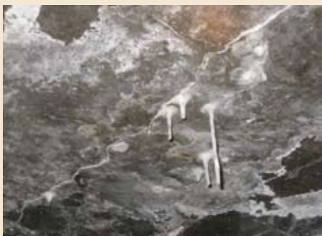
昭和 39 年道示で設計された RC床版の平均的な寿命は約 30 年 (日本橋梁建設協会調べ)
